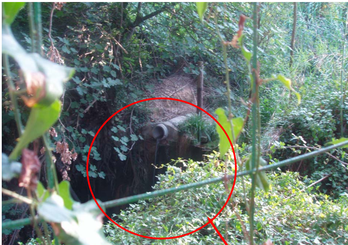
Caída libre de aguas negras desde alcantarillado
